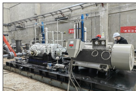
b.CO 2 管输增压泵照片
